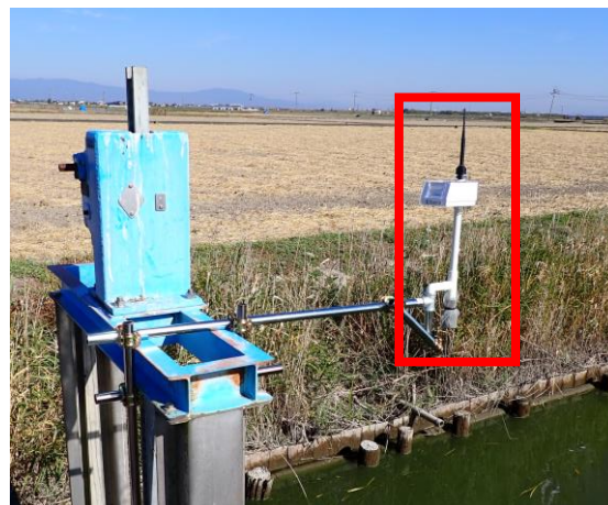
Fig. 2 水位センサーの設置状況 Installation of water level sensor
